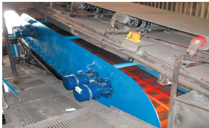
Рис. 6. thyssenkrupp goovi® на заводе по переработке шлака
