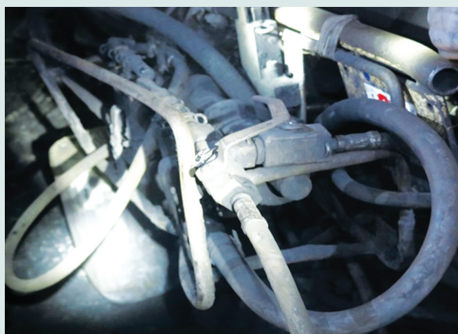
Рис. 2. Общий вид насоса для закачки смолы в инъекционный анкер.
