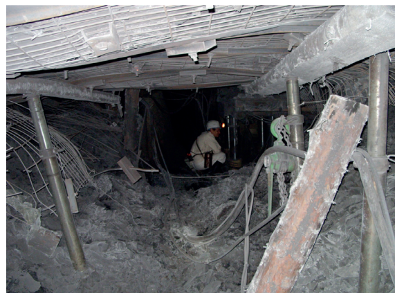
Рис. 2. Обрушение кровли вследствие накопленного пучения.
