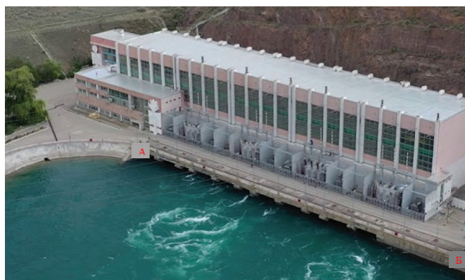
Рис. 1. Место расположения створной линии на трансформаторной площадке Капчагайской ГЭС.
