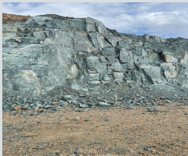
Рис. 6. Вид на деформированный откос уступа. Сурет 6. Кемер қиябетінің деформацияланған көрінісі. Figure 6. View of the deformed slope of the ledge.
